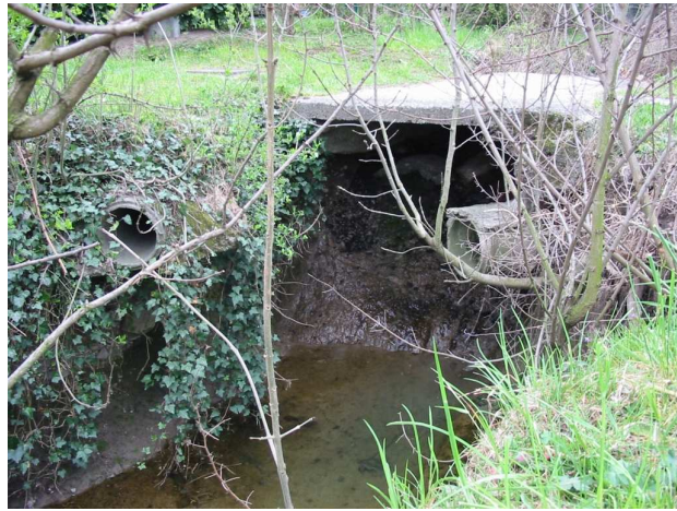
Area di confluenza con la Valle Cepelline a quota 244 m slm caratterizzata da erosione di sponda con fenomeni di sottoescavazione delle opere presenti.
